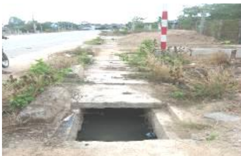
Ảnh 19: Mương nắp đan thoát nước chung
