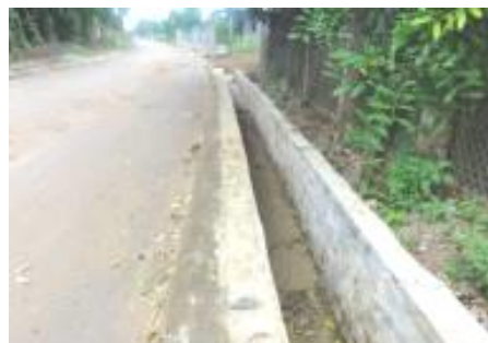
Ảnh 20: Mương hở thoát nước chung
