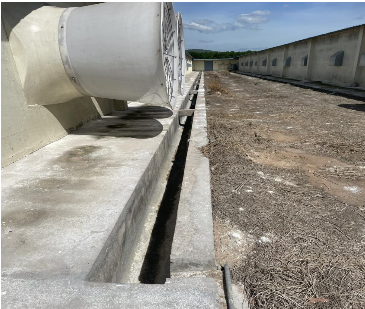
Hình ảnh hệ thống thoát nước mưa của Trang trại
