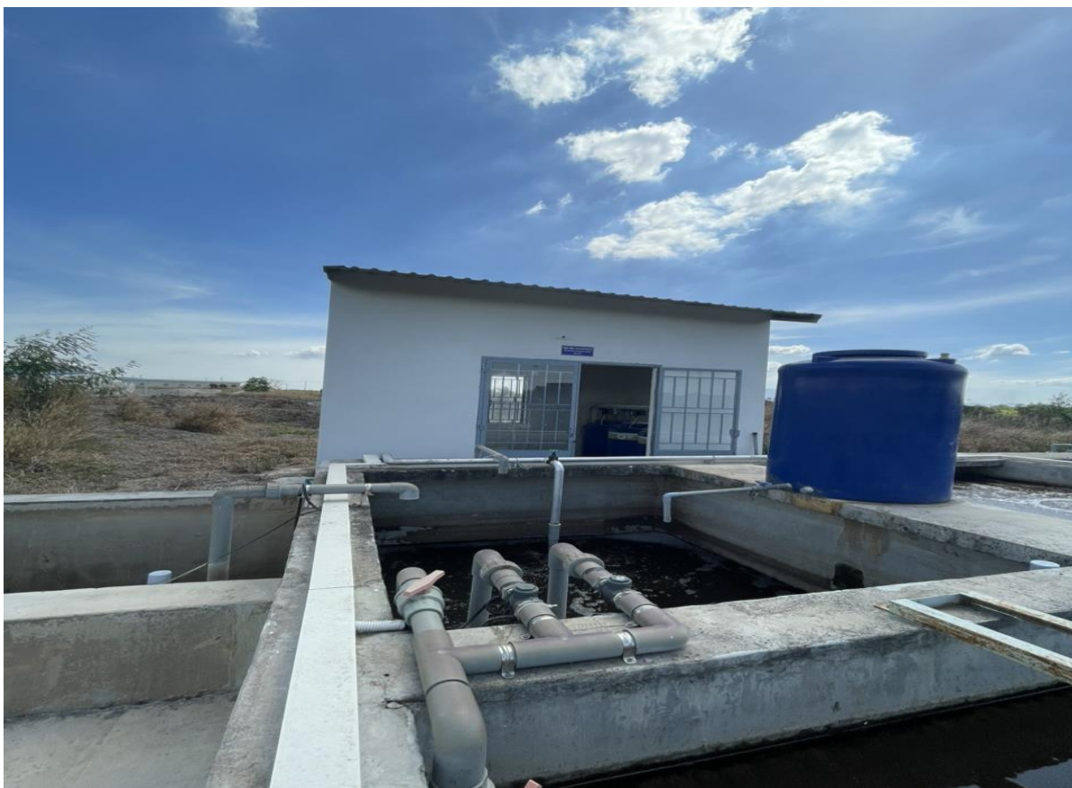
Hình ảnh các công trình HTXLNT của Dự án
