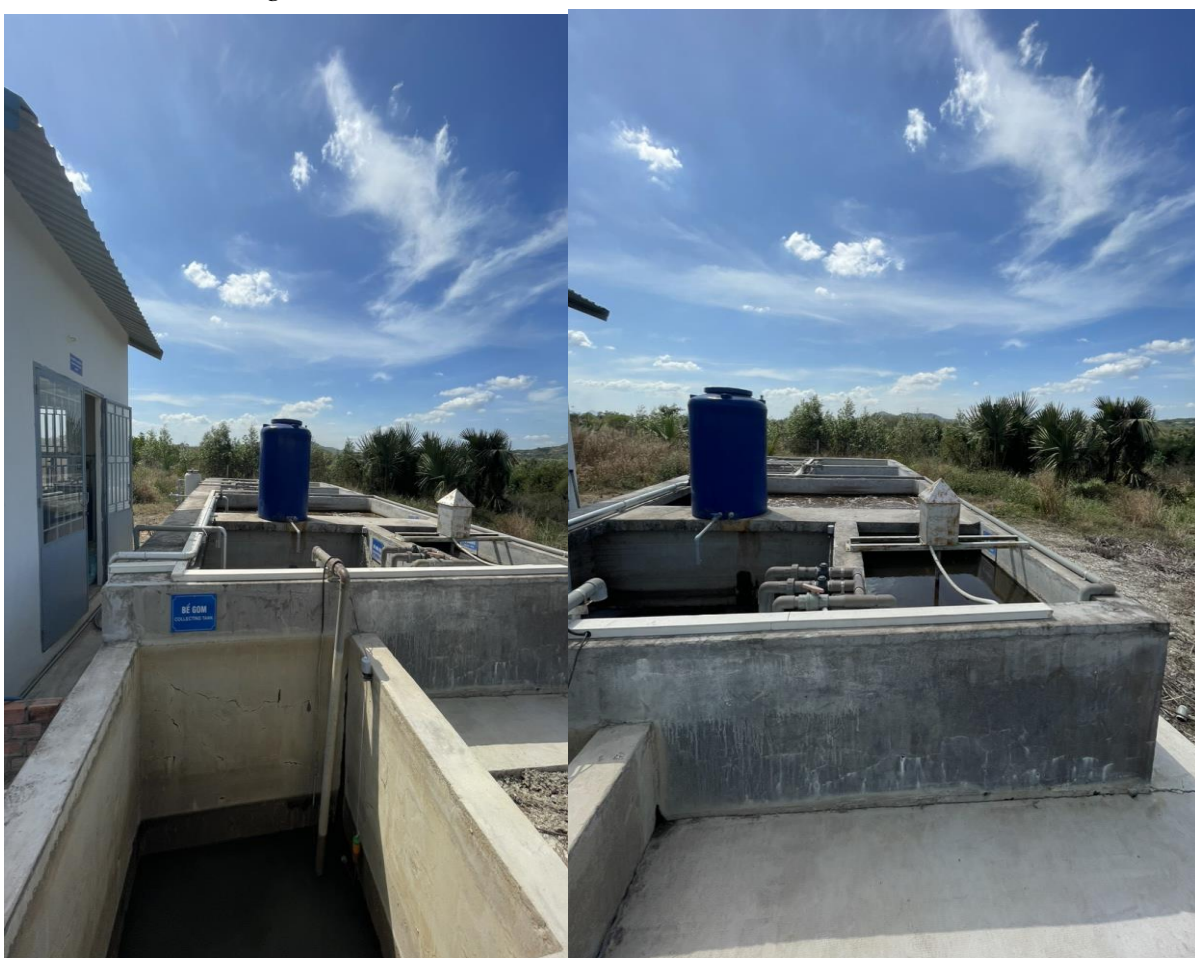
Hình ảnh HTXLNT của Dự án
