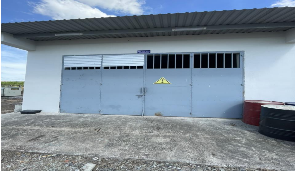
Hình ảnh phòng chứa máy phát điện của Dự án
