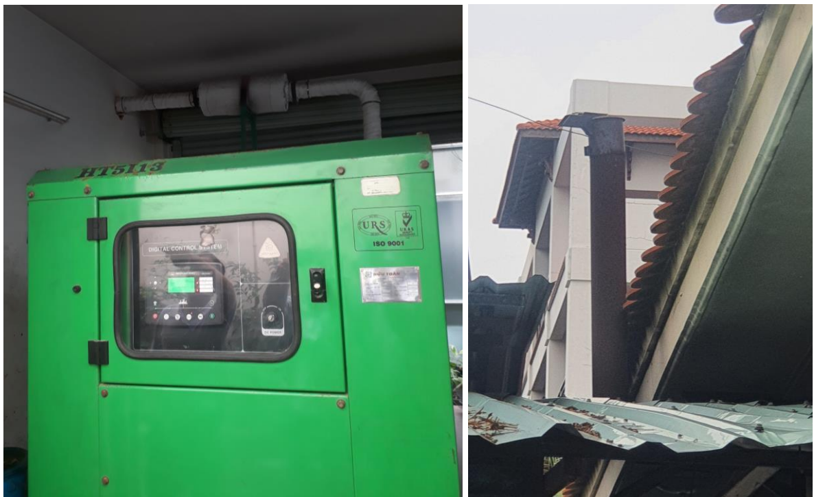
Hình 14. Khu vực máy phát điện và ống khói tại khu A
