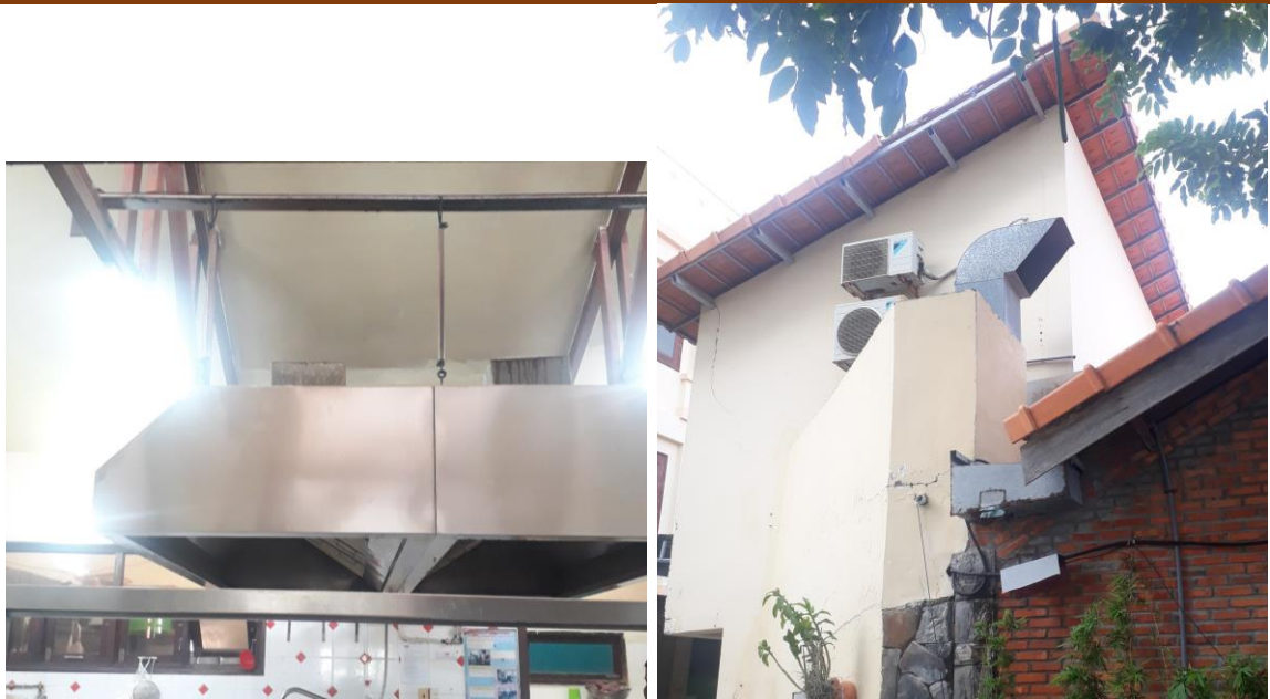
Hình 13. Hệ thống hút mùi và ống khói tại nhà bếp
