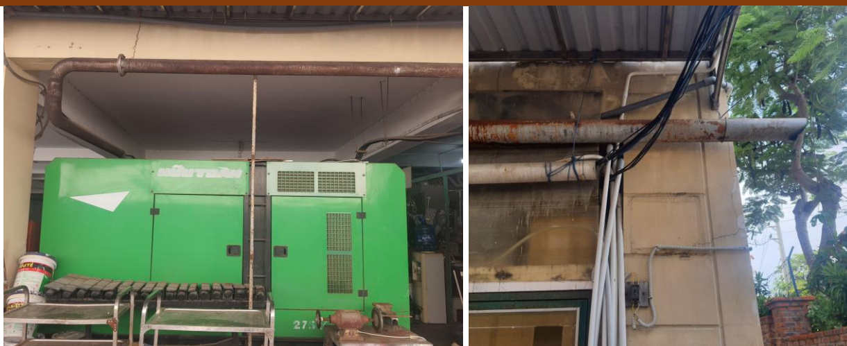
Hình 15. Khu vực máy phát điện và ống khói tại khu B
