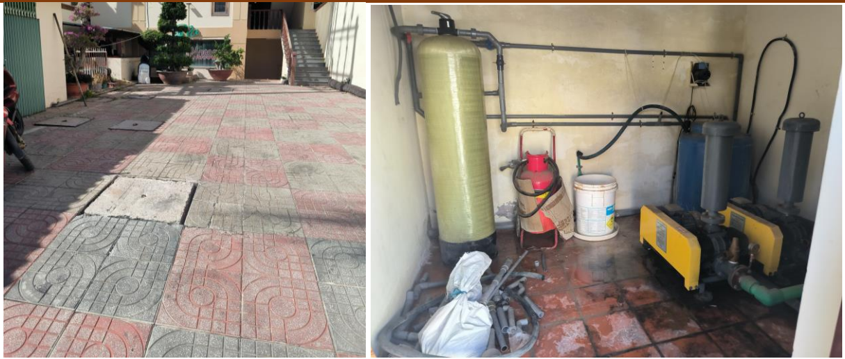
Hình 11. Hệ thống xử lý nước thải tại khu khách sạn
