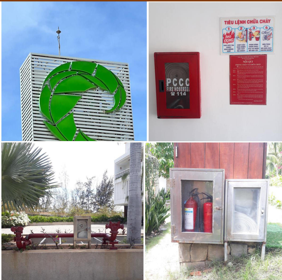
Hình 12. Một số thiết bị PCCC tại khu du lịch
