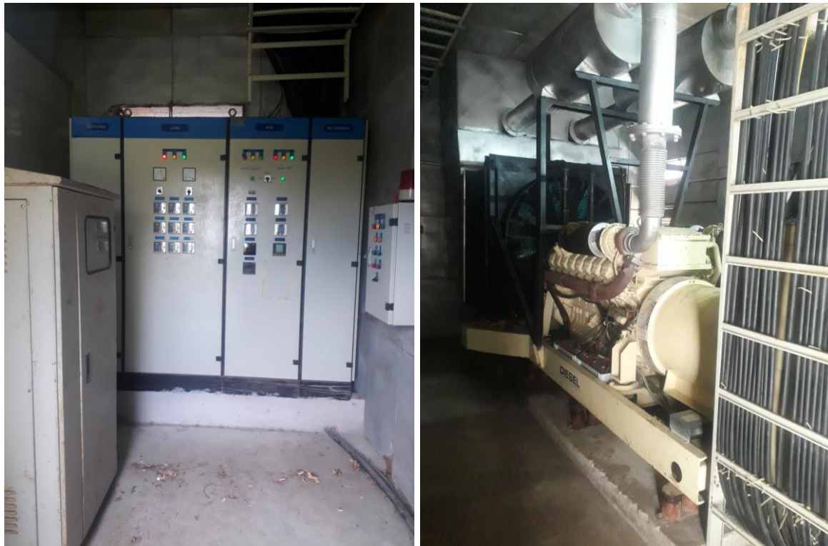
Hình 9. Khu vực máy phát điện
