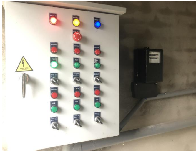
Tủ điện và đồng hồ điện của hệ thống XLNT
