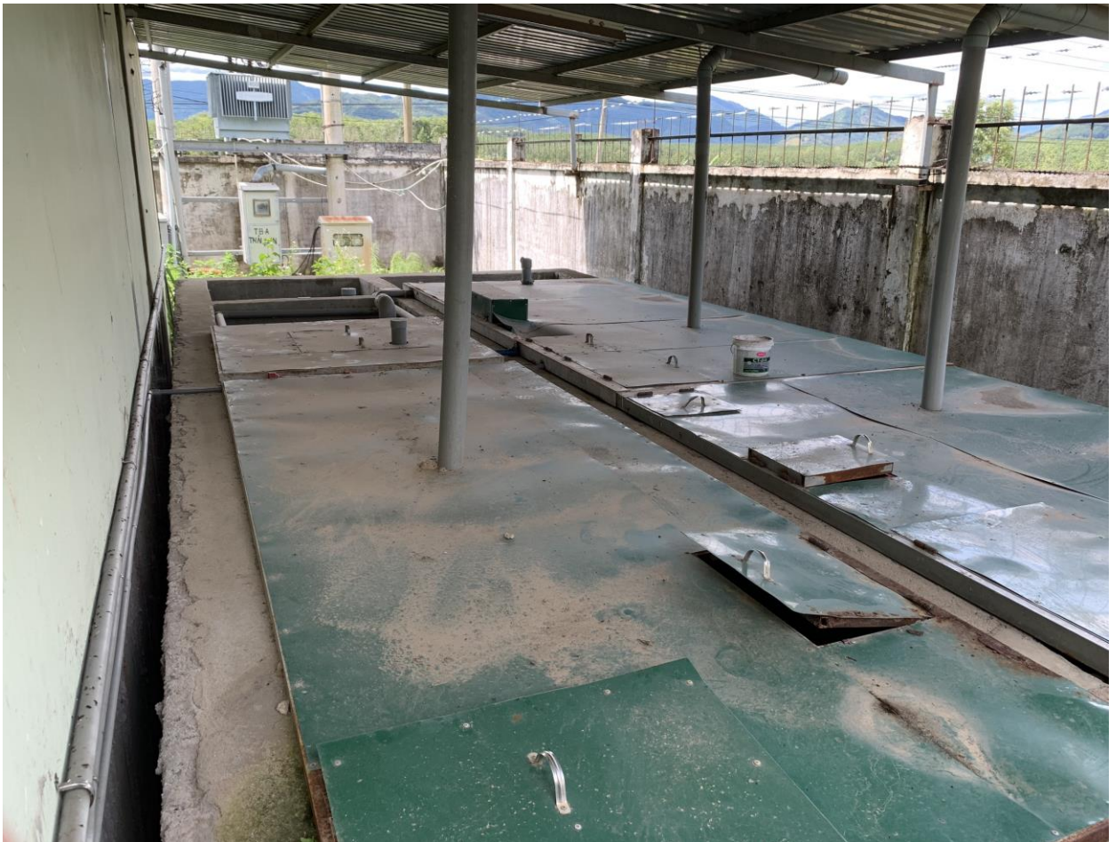
Hệ thống xử lý nước thải tập trung
