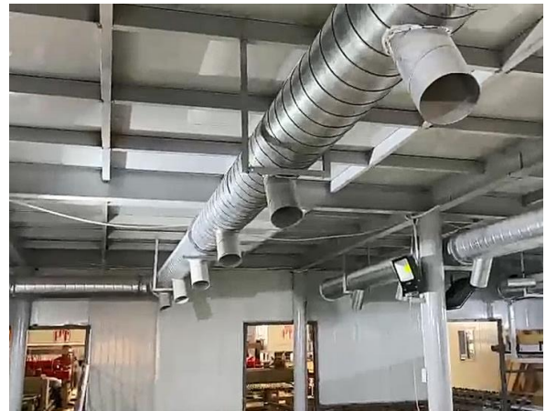
Hệ thống ống xương cá hút bụi, mùi
