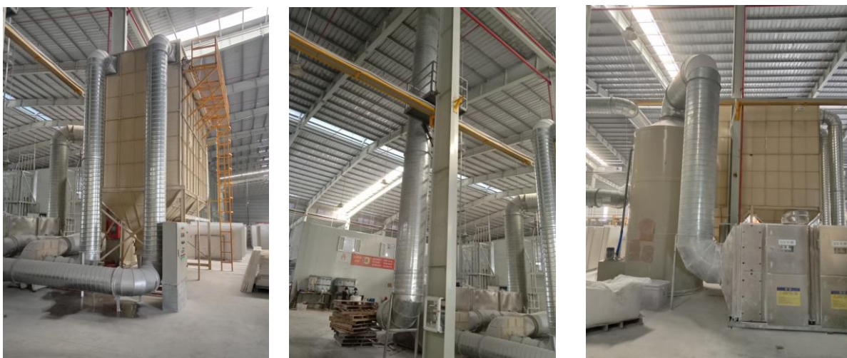
Hình 5. Hệ thống xử lý khí thải tại Nhà máy
