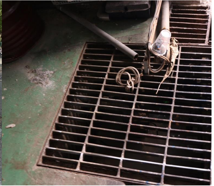
Hình 4. Hồ ga tổng thu nước mưa dưới tầng hầm
