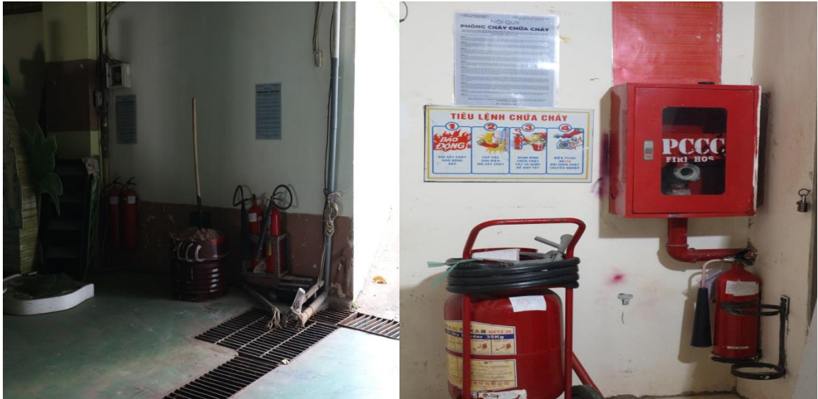
Hình 21. Hệ thống PCCC tại khách sạn
