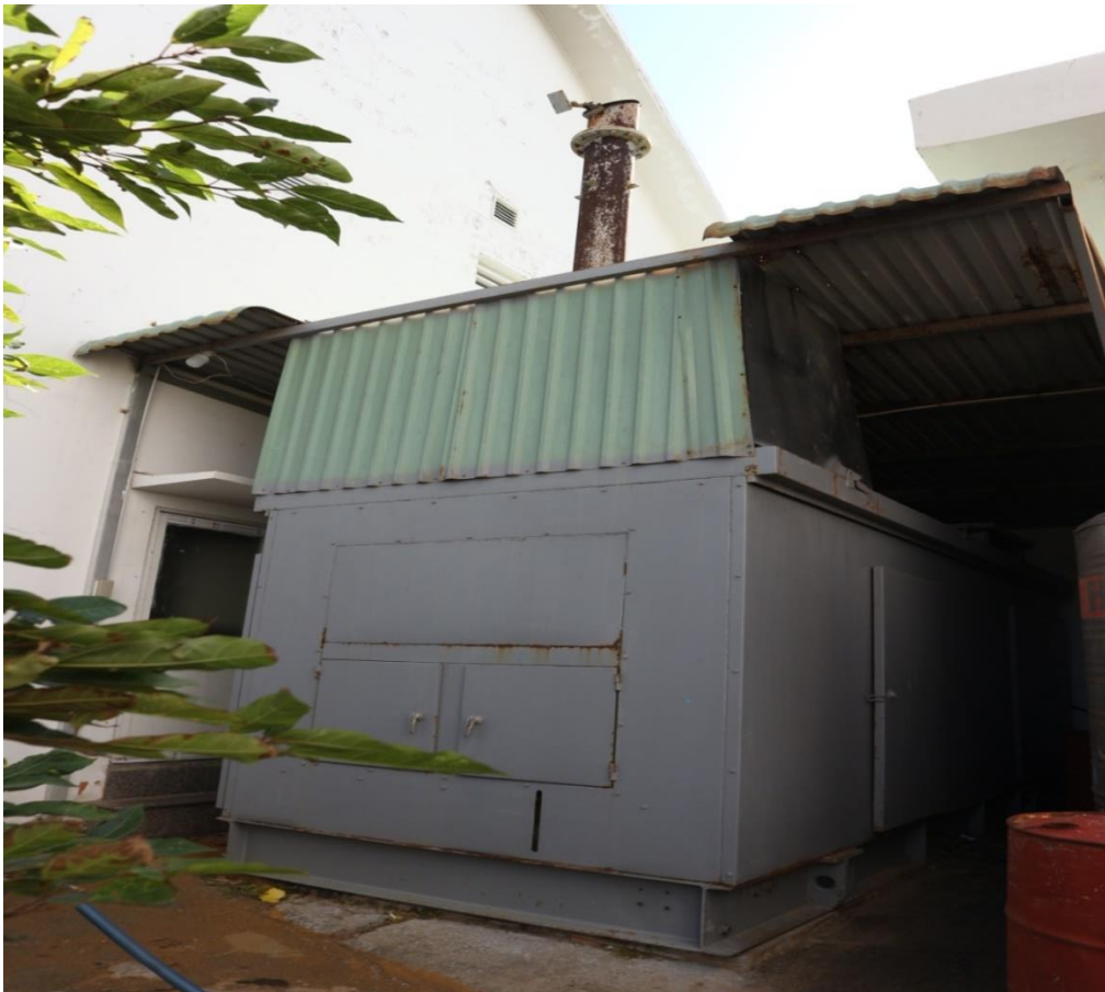
Hình 13. Vị trí đặt máy phát điện dự phòng
