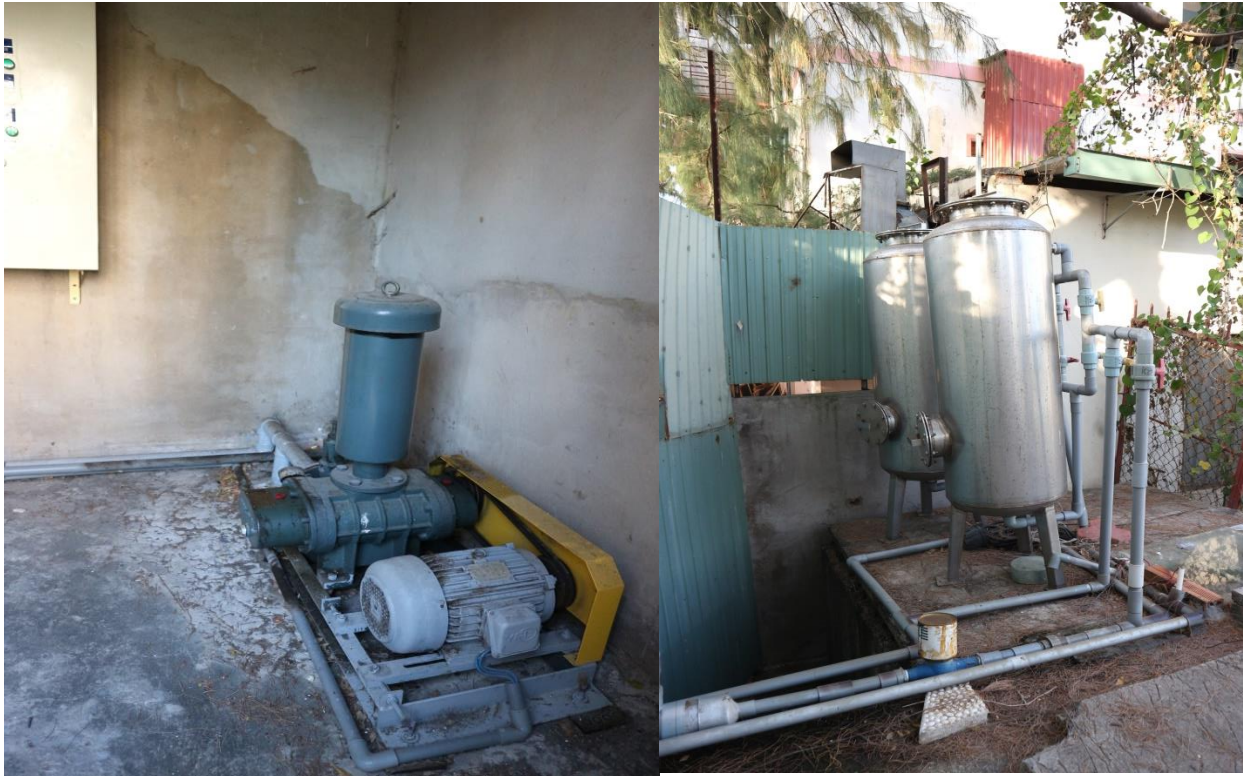
Hình 9. Máy móc thiết bị trong nhà vận hành HTXLNT và bồn lọc áp lực
