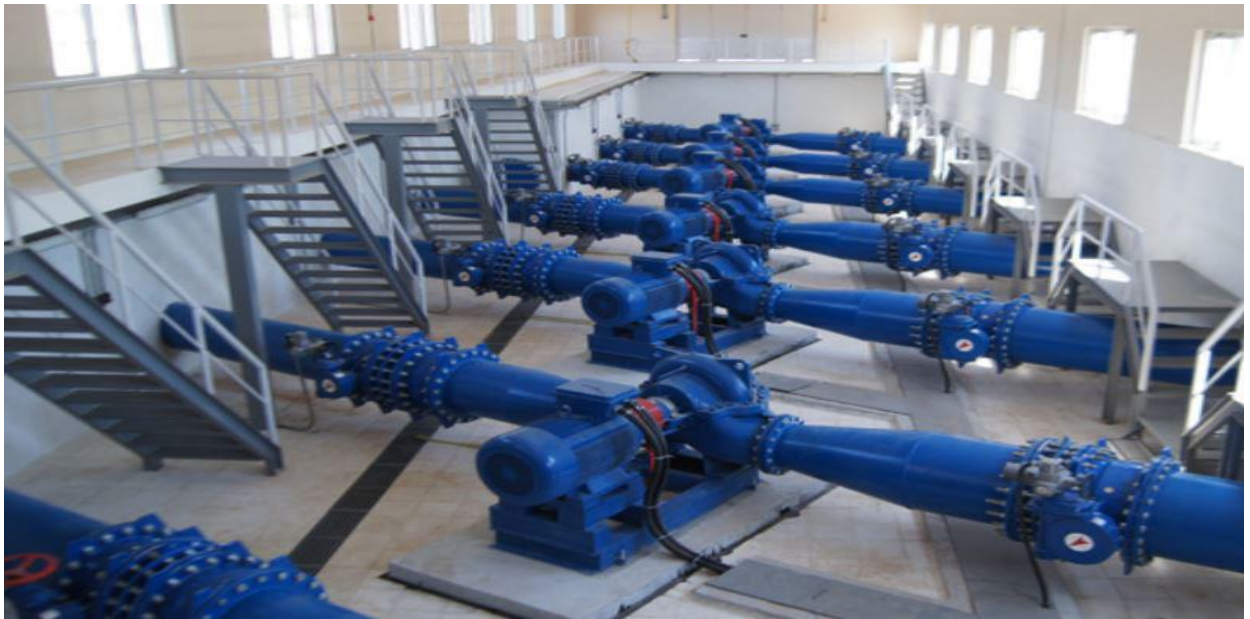
Hình ảnh: Trạm bơm tăng áp tại xã Đông Lĩnh
