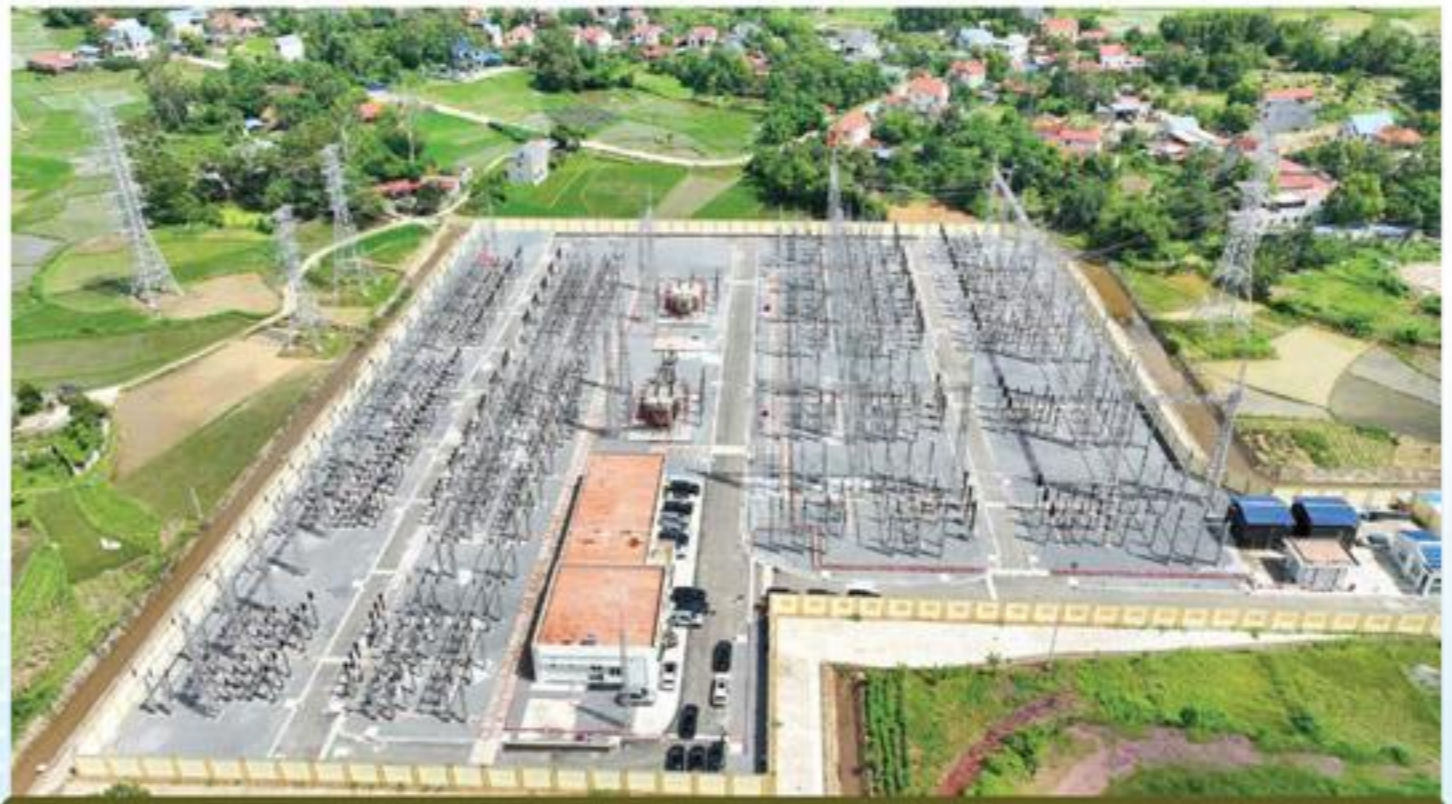
Hệ thống trạm biến áp và truyền tải điện được đầu tư bảo đảm nguồn điện cho sản xuất và đời sống dân sinh
