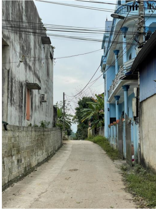
Hình 9n: Hiện trạng đường dây viễn thông đi kèm cột điện hạ thế trong các khu vực dân cư hiện hữu.
