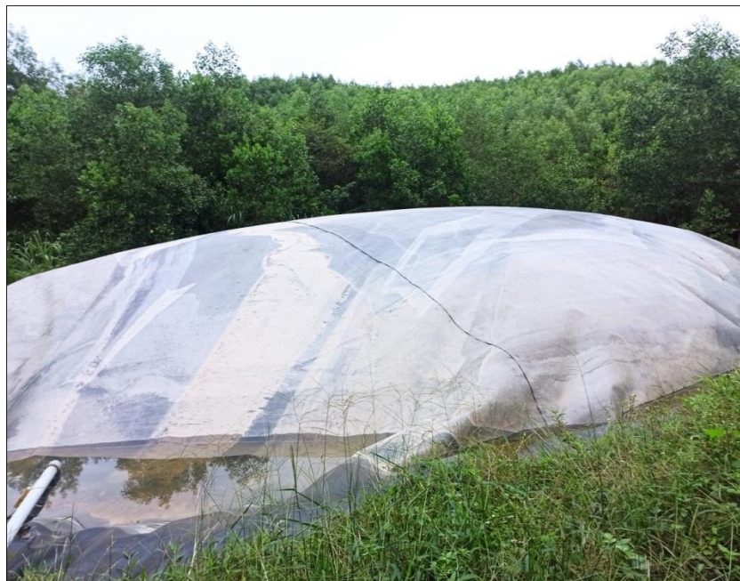
Hình 3.5. Hình ảnh bể Biogas tại cơ sở
