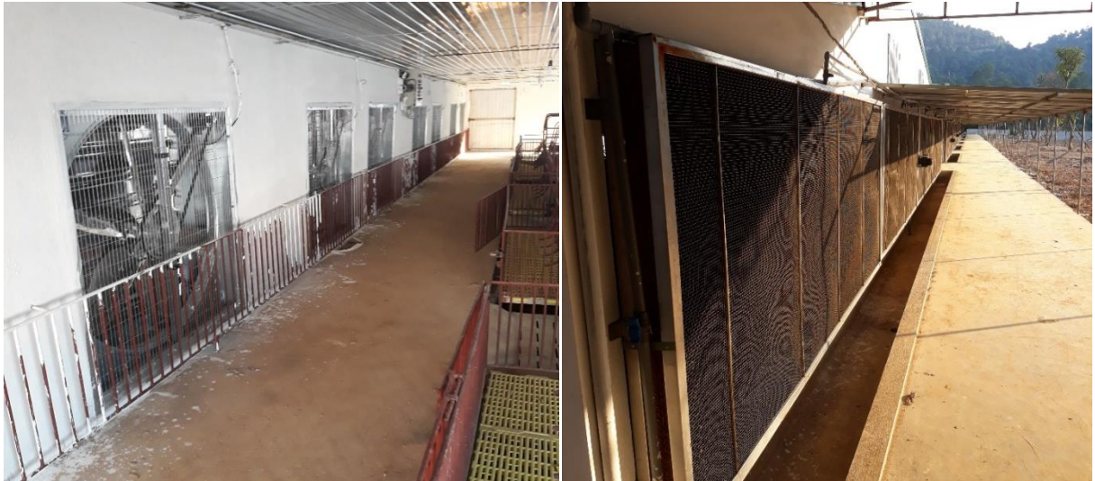
Hình 3.8. Quạt hút gió và hệ thống làm mát chuồng trại
