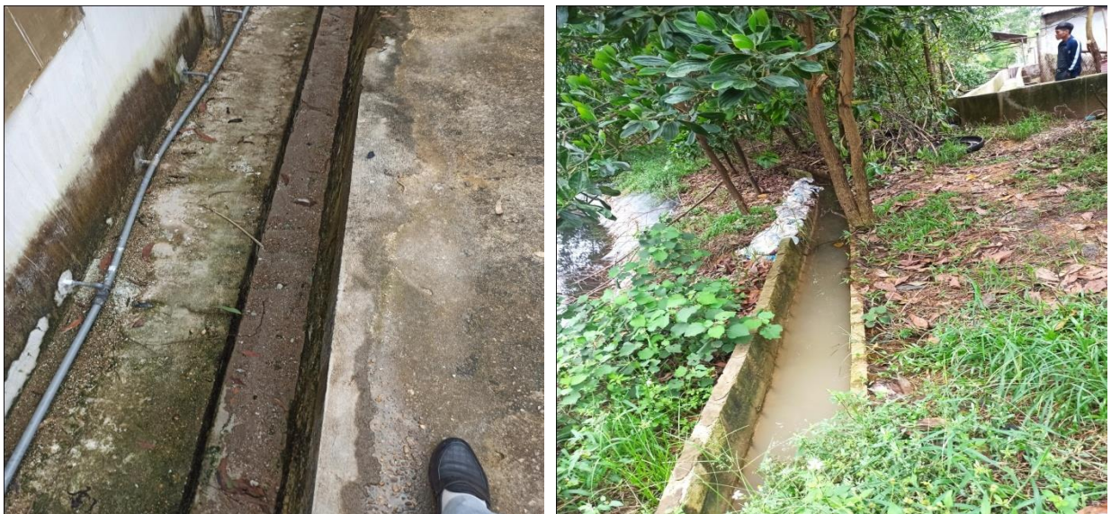
Hình 3.2. Rãnh thu gom và thoát nước mưa
