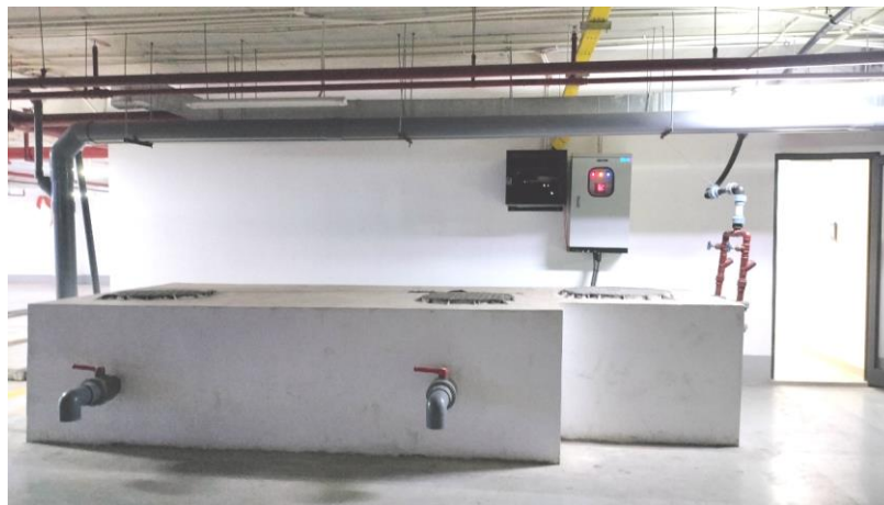
Hình 3.1. Hình ảnh bể tách dầu của Showroom Vinfast
