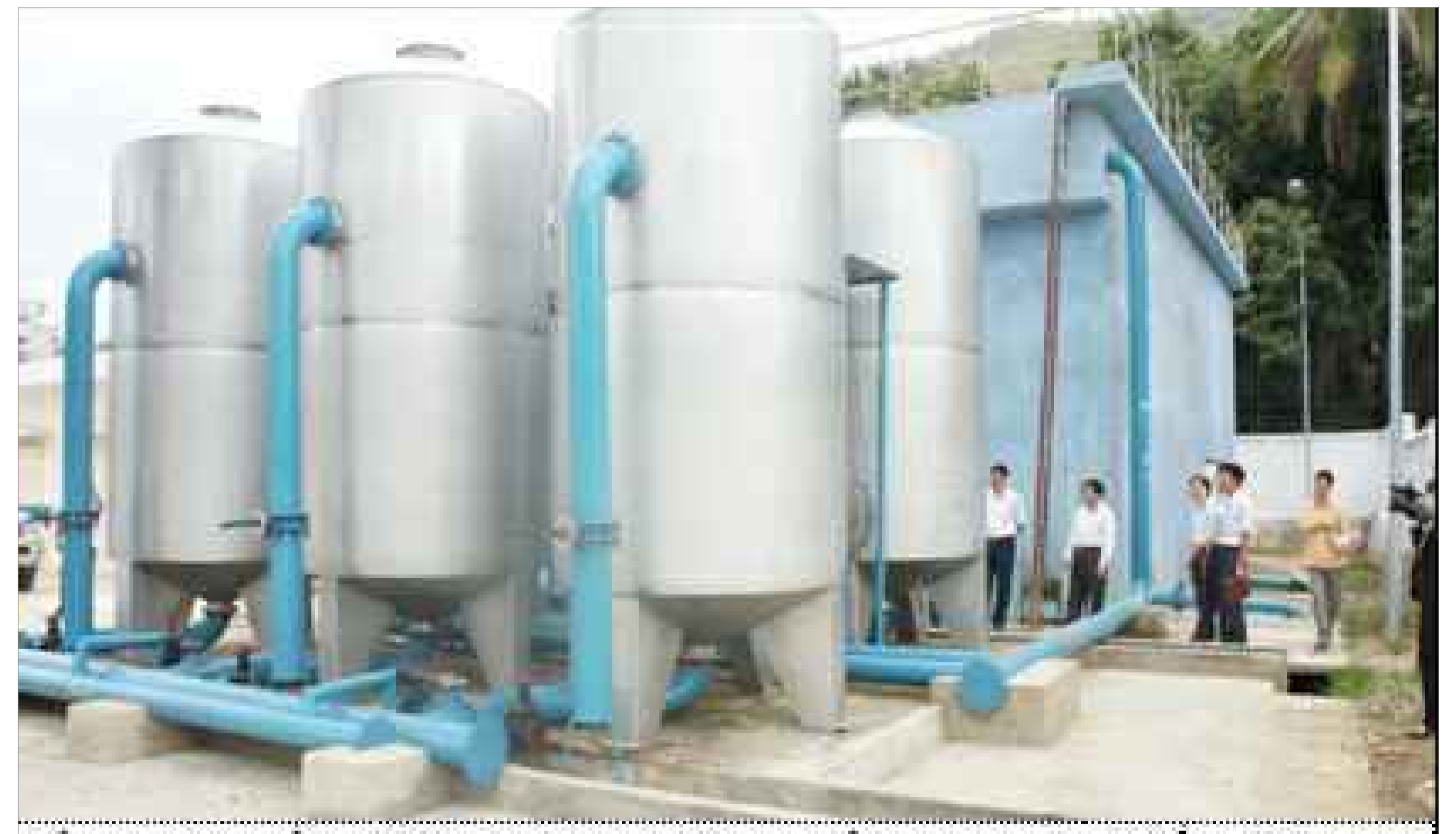
TRẠM CẤP NƯỚC SINH HOẠT XÃ CHIỀNG KHƯƠNG
