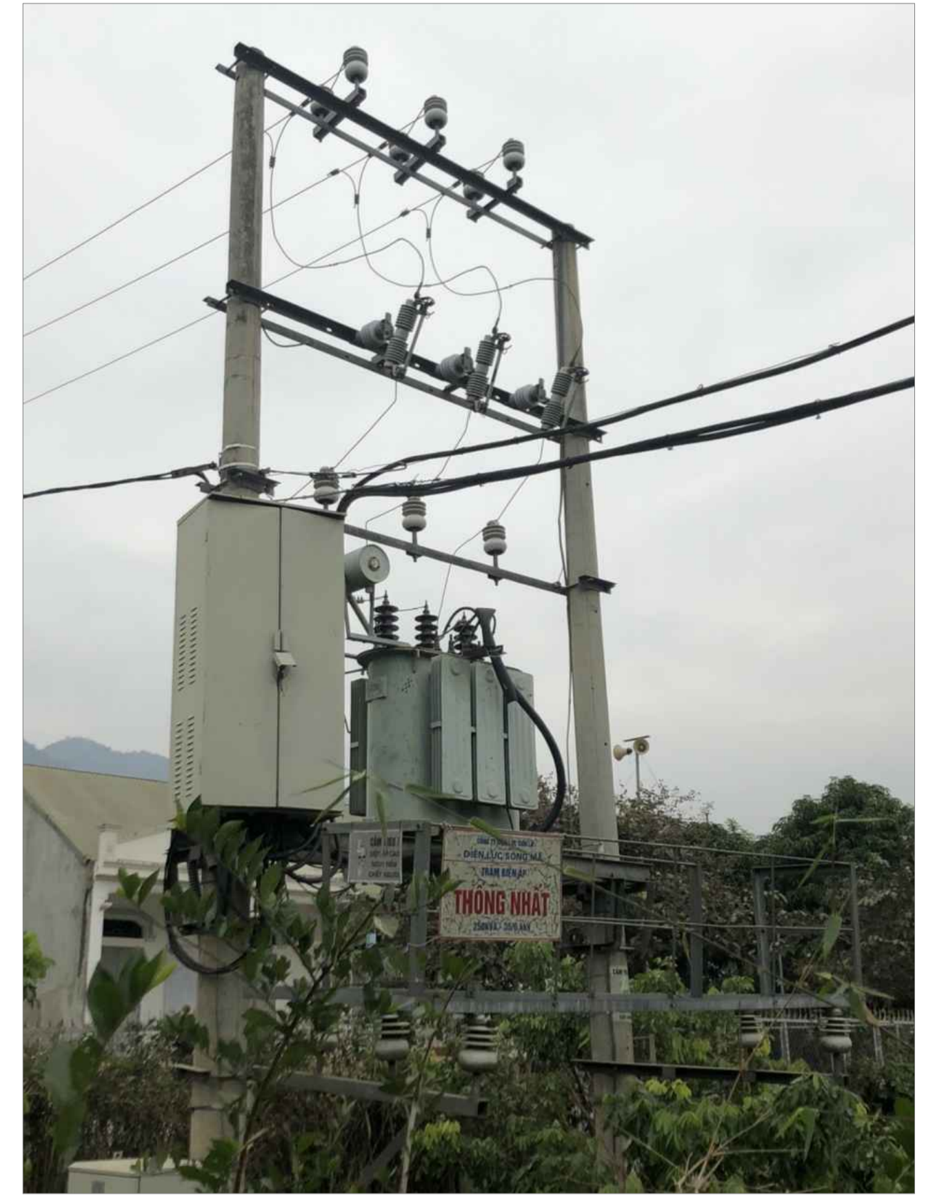
TRẠM BIẾN ÁP
